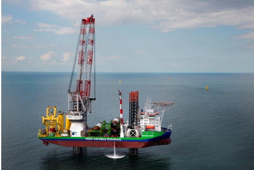
Le jack-up 'Innovation' de GeoSea en pleins travaux d'installation au niveau du parc éolien offshore de Westermost Rough, au Royaume-Uni.
