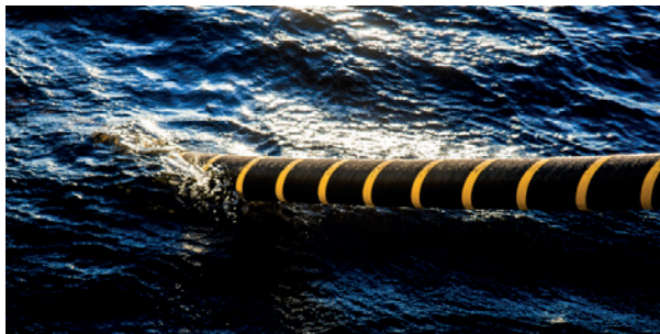
câble d'exportation de 220 kv
